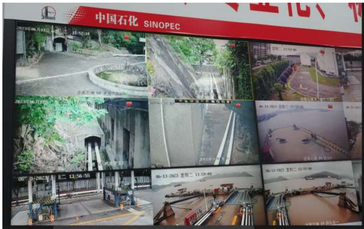
图 2.8-1 控制室显示监控界面
