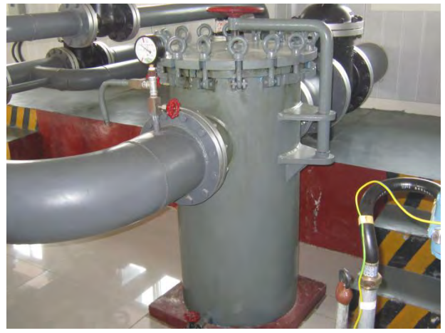
快卸式过滤器池
